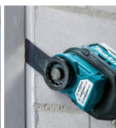
Corte de masilla de ventanas, silicona.
